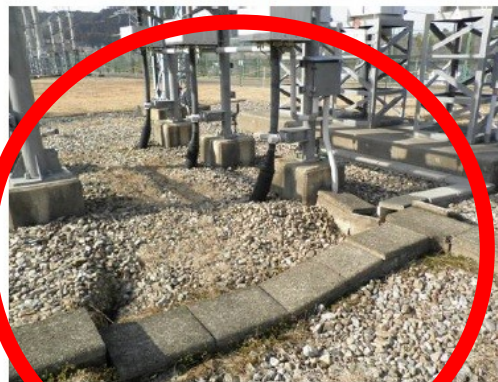
撮影：東京電力株式会社 H23.3.12
