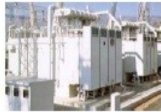
起動変圧器の例
