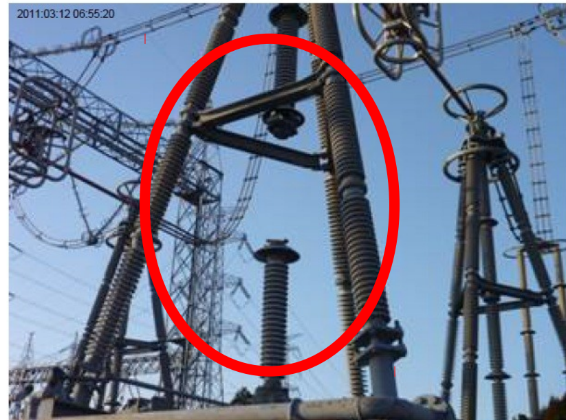
撮影：東京電力株式会社 H23.3.12
