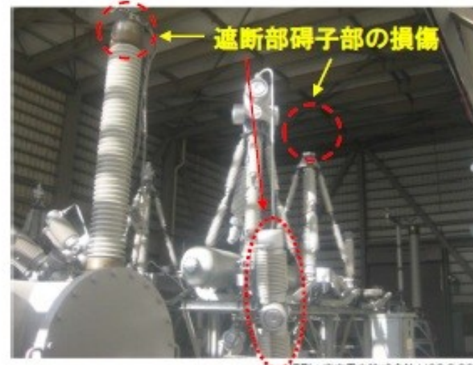
撮影：東京電力株式会社 H23.3.23
