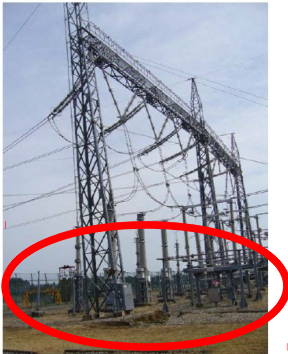
撮影：東京電力株式会社 H23.3.11
