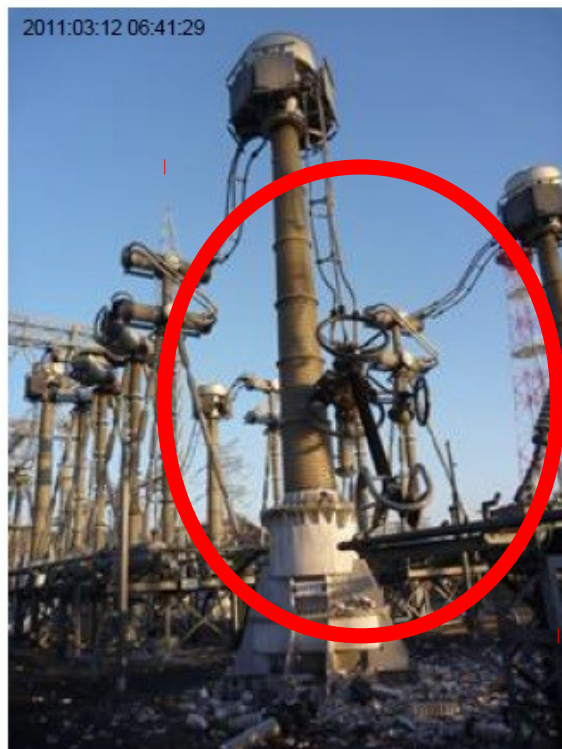
撮影：東京電力株式会社 H23.3.12
