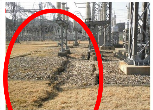
撮影：東京電力株式会社 H23.3.12
