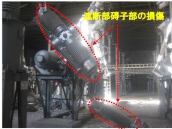
撮影：東京電力株式会社 H23.3.23
